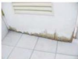
門下方已被水泡腐
